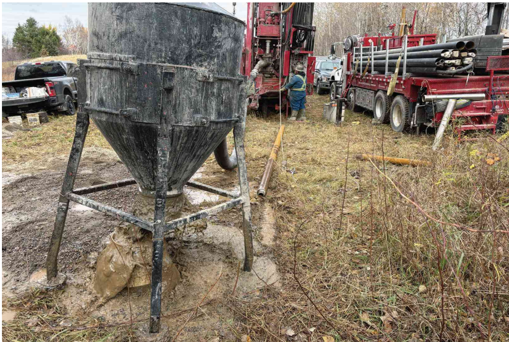
Planche 6. Vue du débit d'eau souterraine de l'ordre de 945 L/min sortant du cyclone de dépressurisation au moment de l'exécution du forage stratigraphique MB-4
